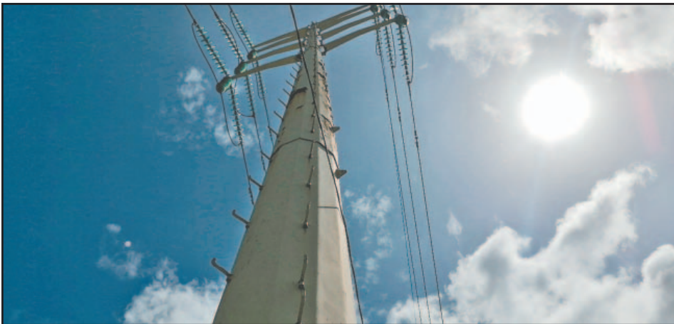
Las sobrecargas de corriente de igual forma afectan las instalaciones. (Perla Prado)
