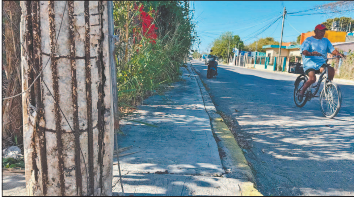
La estructura del mástil está muy dañada por el paso del tiempo y la falta de mantenimiento. (Jorge May)
