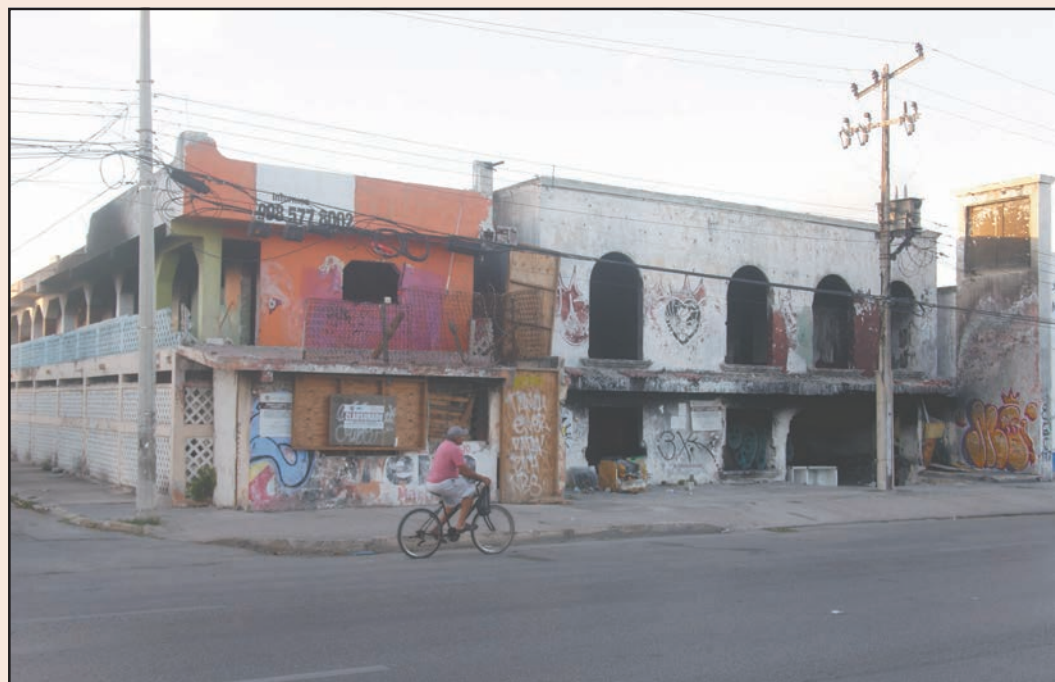
Estructuras del hotel Posada Acapulco presentaron daños severos y riesgo de colapso. (E. Romero)
