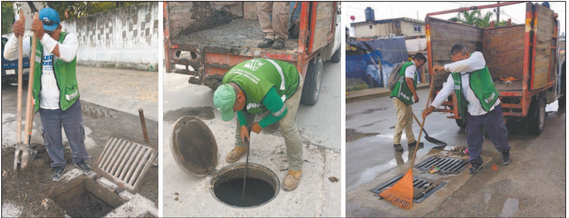
Trabajadores retiraron lodo y basura de la infraestructura hidráulica, con el fin de facilitar el flujo pluvial y evitar obstrucciones en las vialidades de la ciudad. (Fotos POR ESTO!)
