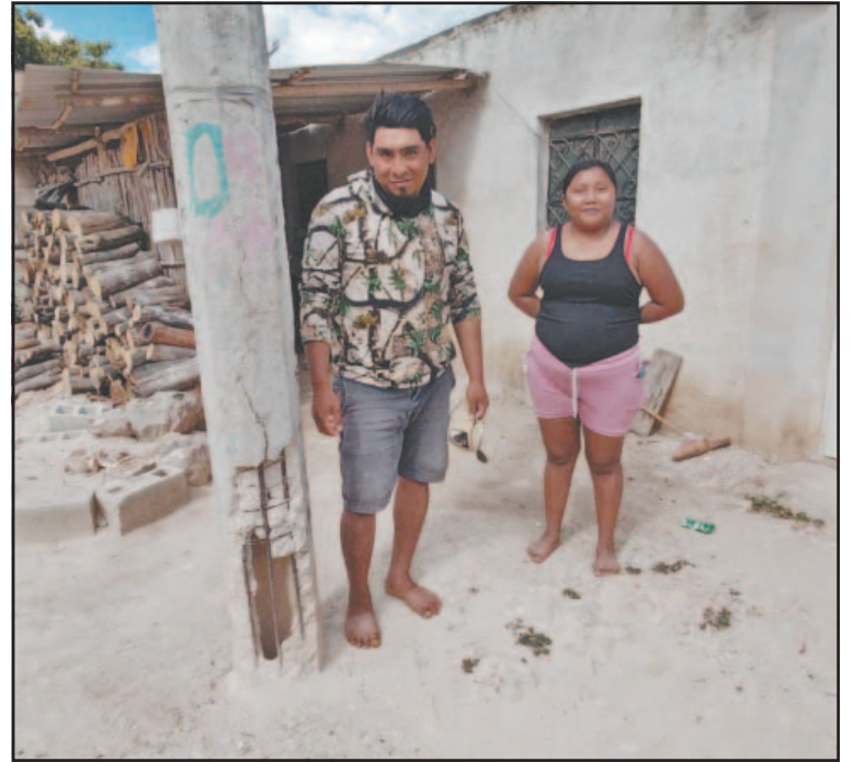
La estructura se mueve con el viento, generando temor de quiebre.
