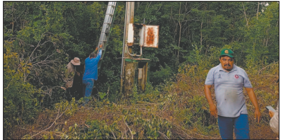
Indicaron autoridades que personal técnico labora en las reparaciones. (Fotos A. Blanco)
