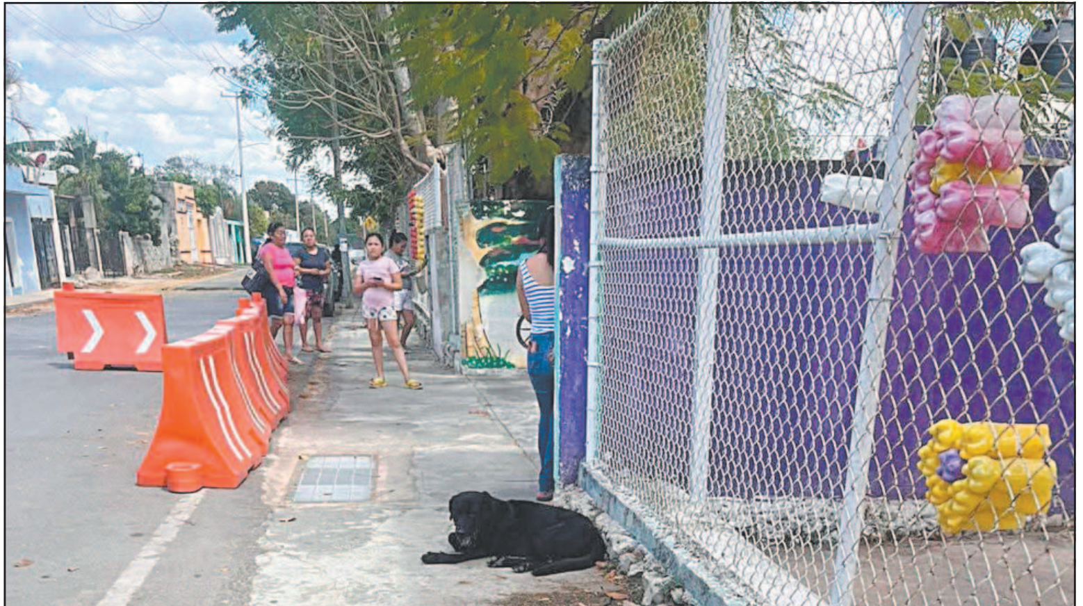
Según los padres de familia, la escuela recibió más de 500 mil pesos de un programa; sin embargo, hay muros a puntos de colapsar y otros daños.
