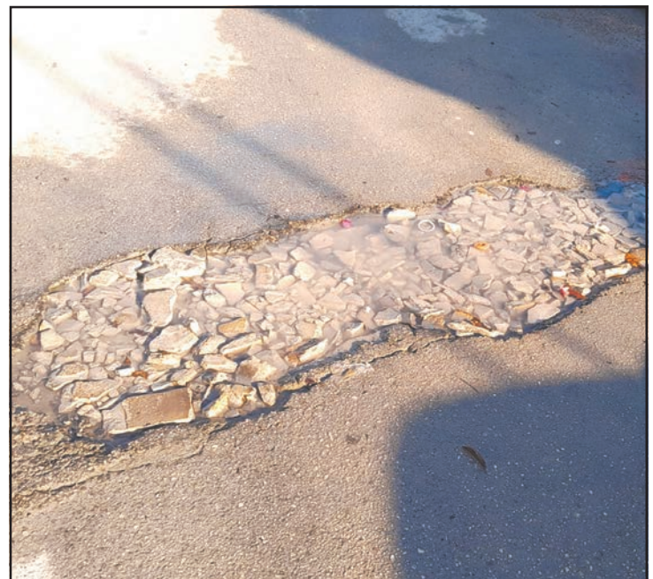
Un tramo de la calle Kom con Yakashiu presentó deterioro. (POR ESTO!)
