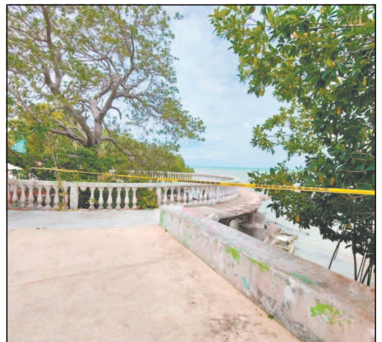
La estructura del mirador colapsó en el 2022; no la han renovado. (F. Baeza)
