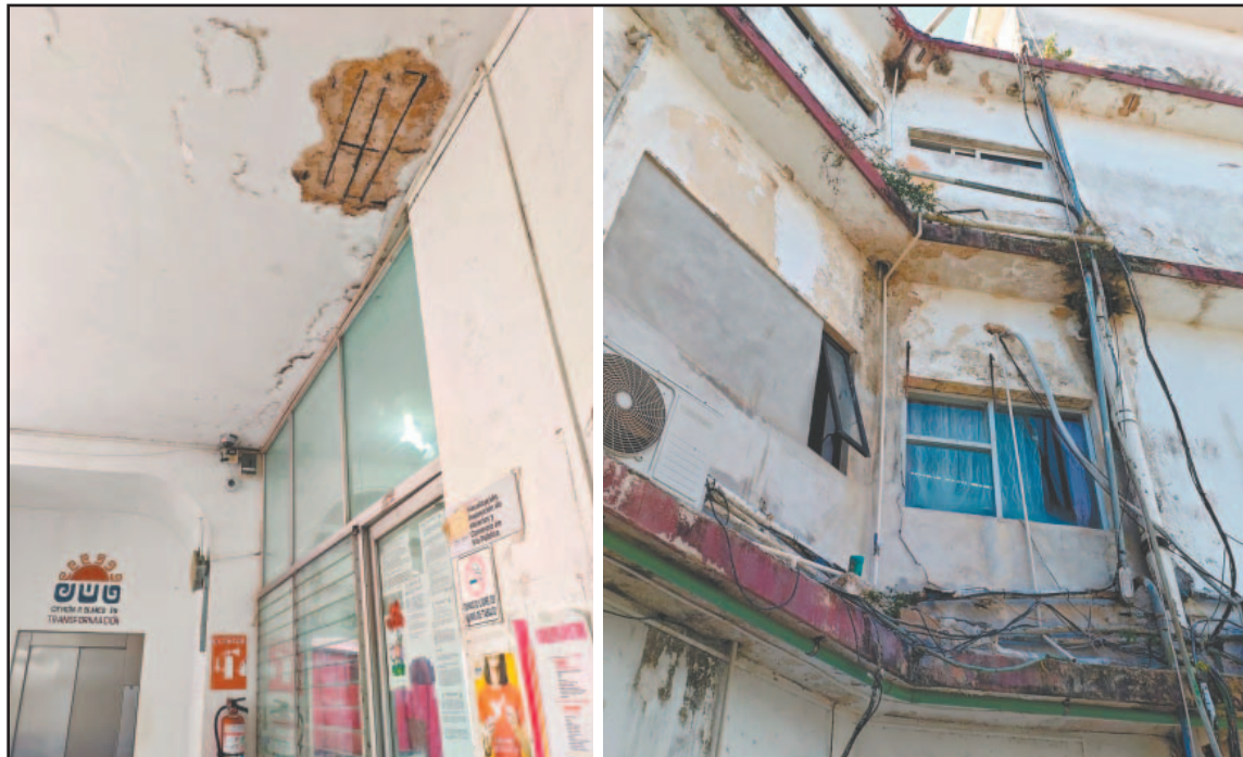
Durante un recorrido se observaron las varillas; en la parte exterior los cables están expuestos. (Fotos F. Olvera)
