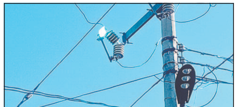
Las chispas en los cables eléctricos se veían desde varios metros.
