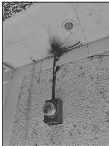
Un cortocircuito quemó cables, sin que el fuego se propagara. (A. Pech)
