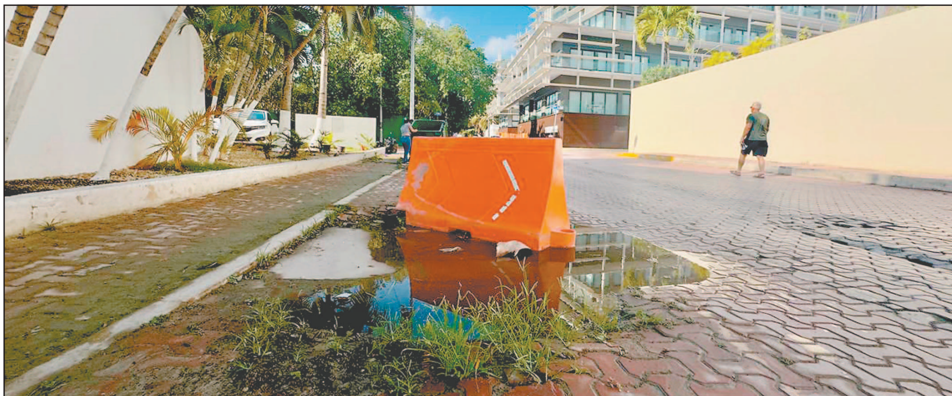
Residentes apuntaron que es responsabilidad del Gobierno municipal arreglar el tramo afectado y realizar los estudios para una cimentación adecuada. (Gustavo Escalante)
