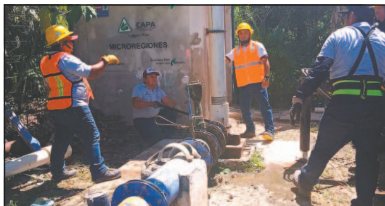
El Pozo 2 suspendió el suministro durante cuatro horas. (Justino Xiu)
