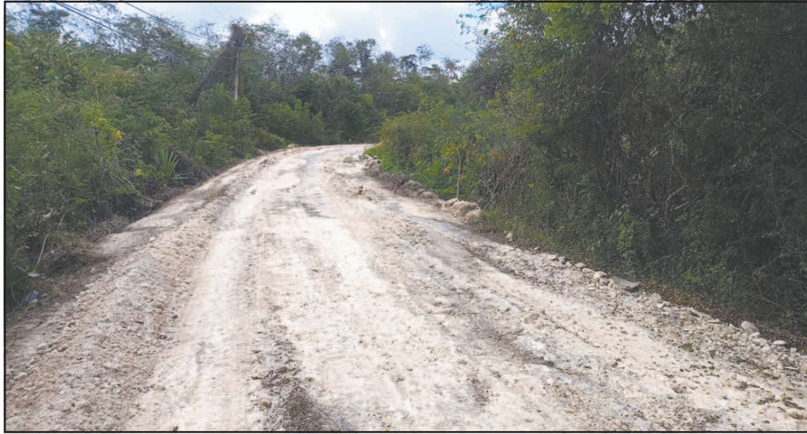
El Ayuntamiento envió maquinaria para retirar el asfalto deteriorado y nivelarlo con sascab. (Lusio Kauil)
