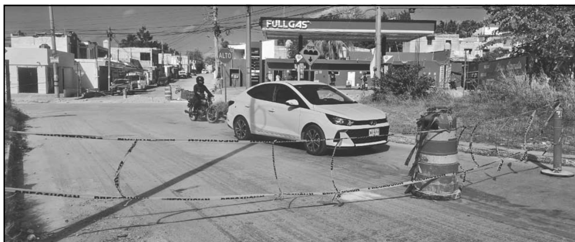
Lugareños de la zona norte denunciaron la falta de señalización y retrasos en instalación de tuberías.
