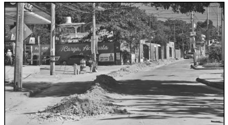
Afectados señalaron que los trabajos llevan más de 15 días. (A. Pech)
