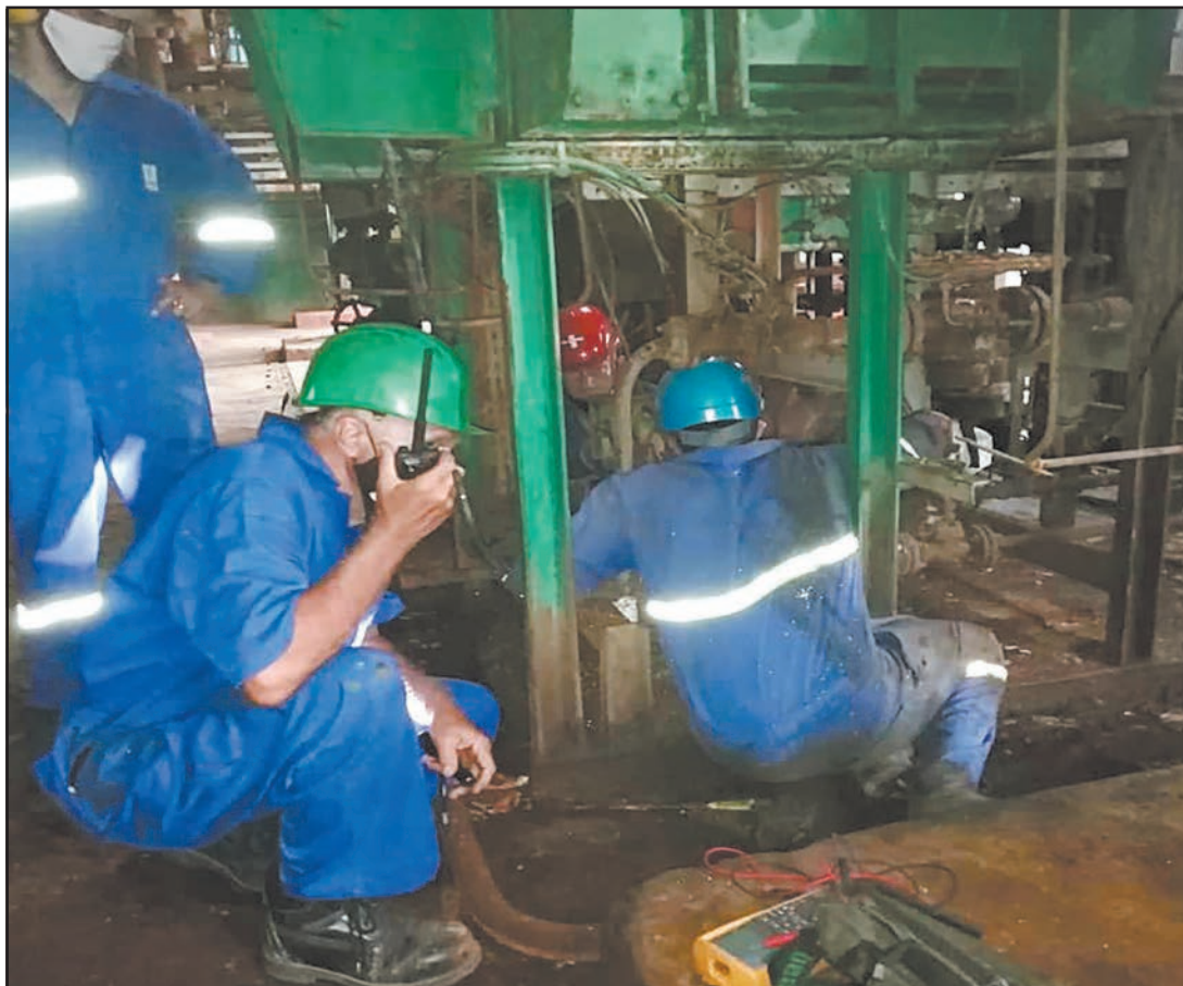
Una avería provocó la desconexión inesperada, de la Termoeléctrica Antonio Guiterras. (Agencias)
