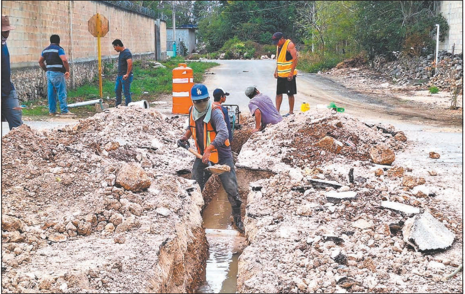
Los habitantes del municipio se han quejado de la falla en el bombeo y suministro, al parecer, por cortes en la energía eléctrica. (J. Xiu)
