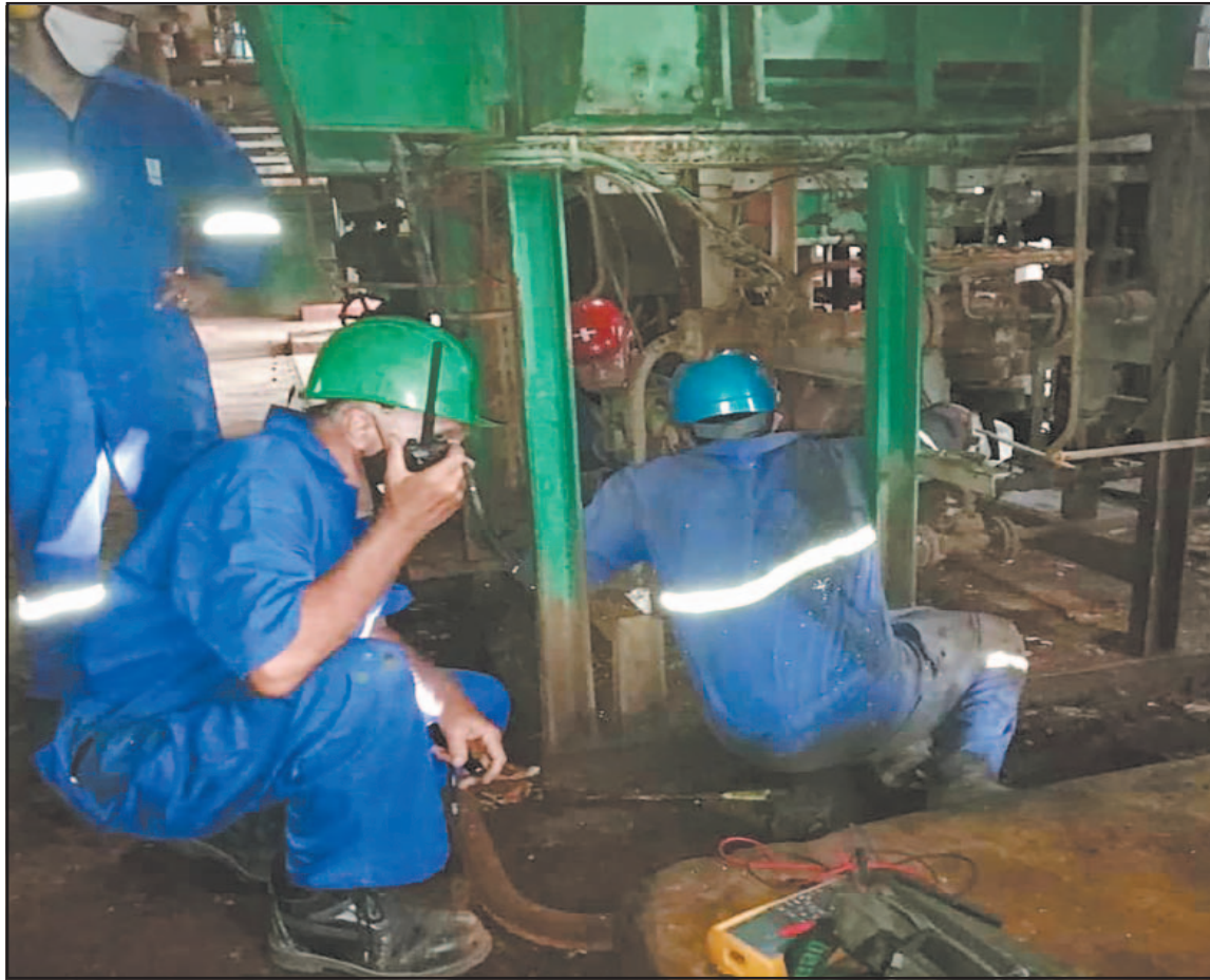
Una avería provocó la desconexión inesperada, de la Termoeléctrica Antonio Guiteras. (Agencias)
