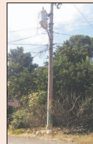
Las estructuras están deterioradas. (POR ESTO!)
