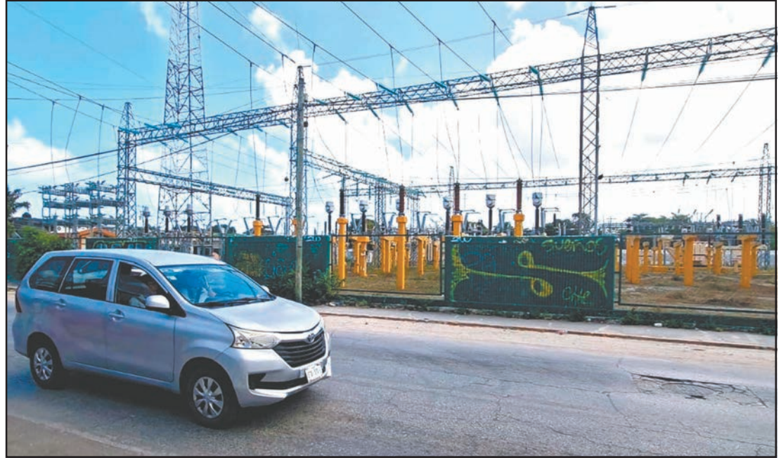
Con presupuesto de 166 millones de pesos, en Chetumal edificarán la subestación Oxtankah. (Liza Vera)
