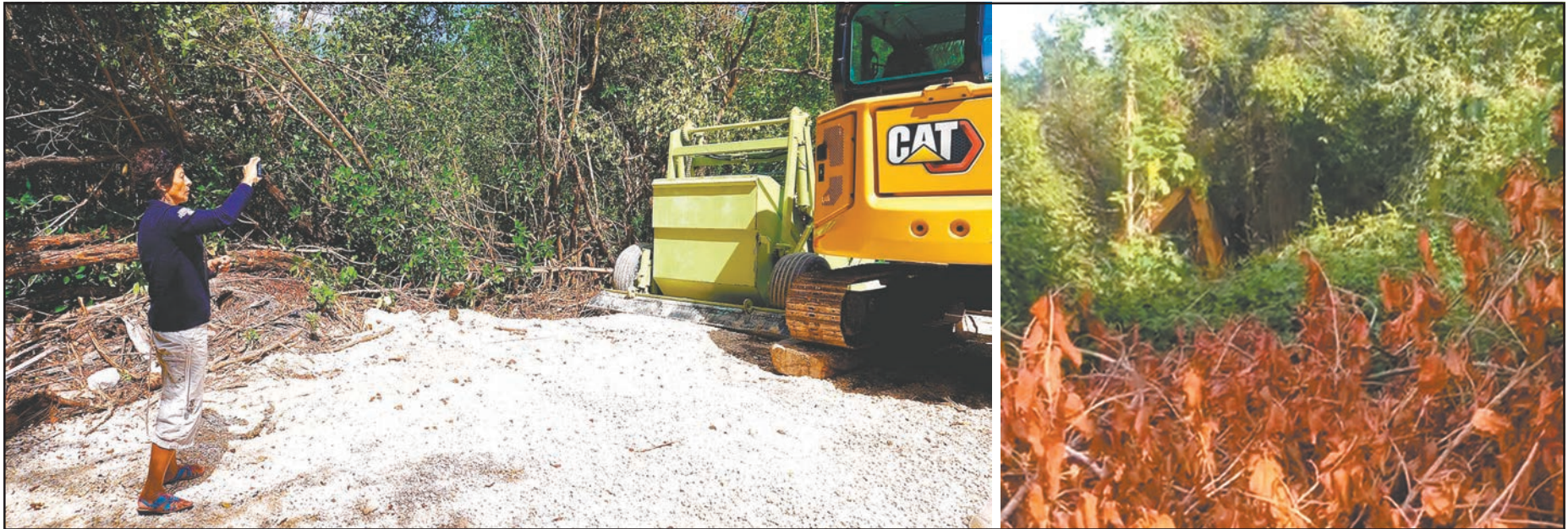
Usuarios de redes sociales achacaron el desmonte a una empresa constructora que hizo labores atrás de la planta de tratamiento de Villas Morelos II. (Fotos POR ESTO!)
