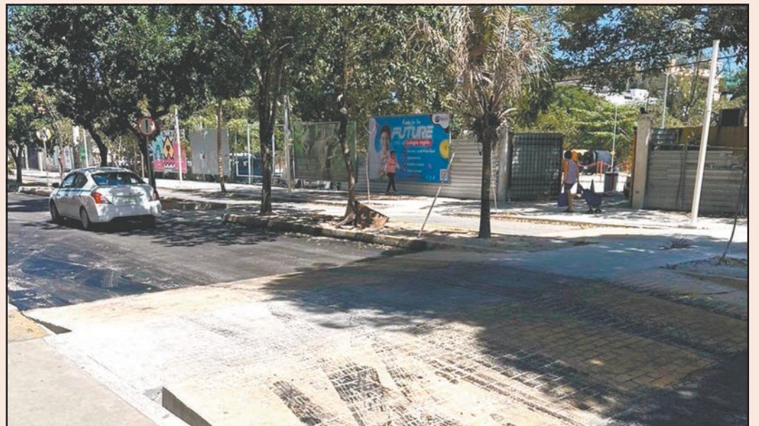
Los peatonales y banquetas están manchados de chapopote, lo que refleja un mal trabajo. (G. Escalante)
