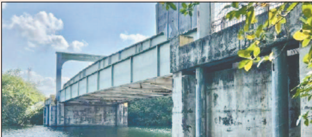
El proyecto de rehabilitación contempló guarniciones, muro de acceso y señalética. (POR ESTO!)
