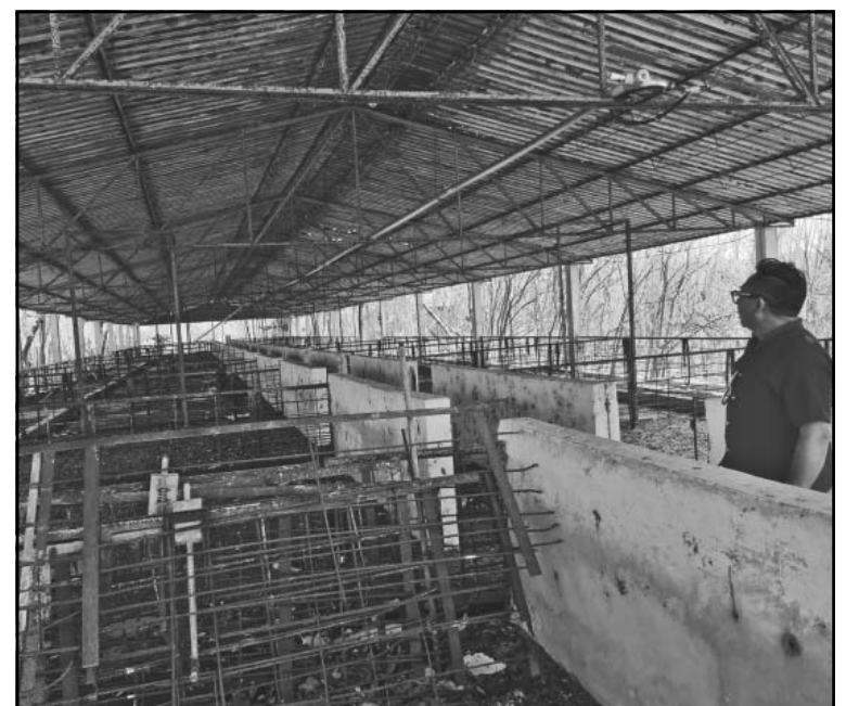
La infraestructura está dañada y necesita bastante capital. (A. Caamal)
