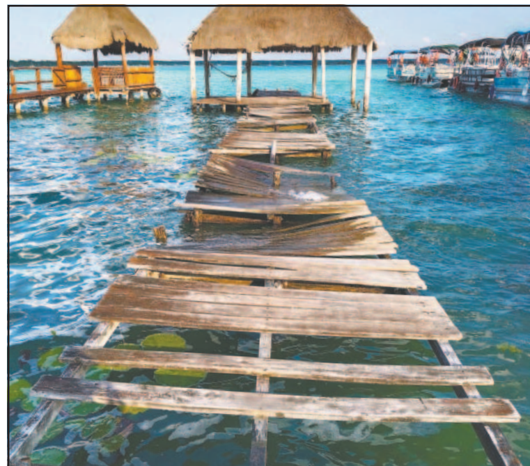
Varios sectores fueron desprendidos o hundidos. (POR ESTO!)
