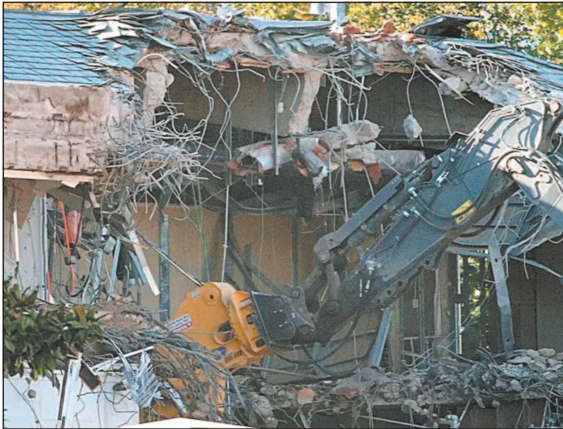
Para finales de octubre del año pasado, ya habían demolido parte del Ala Este de la mansión. (Agencias)
