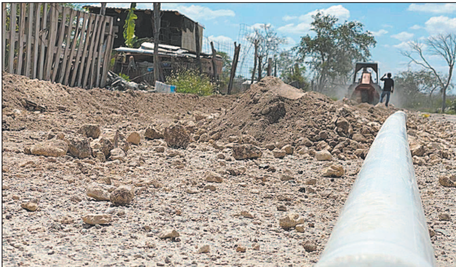
Los conductos fueron liberados, lo que permitió que el líquido corriera de nuevo con la presión suficiente para evitar el desabasto.
