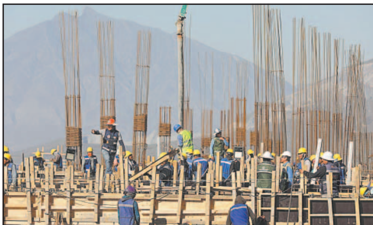
La Secretaría podrá levantar y rehabilitar nosocomios. (POR ESTO!)
