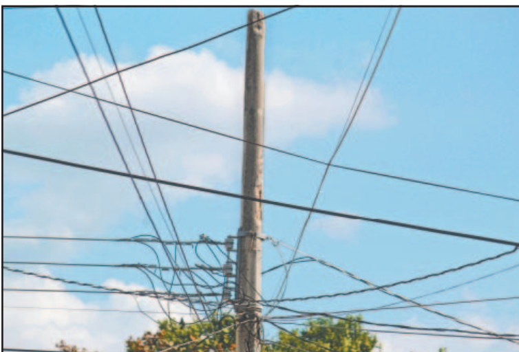
Desde hace un par de años que comenzó a deteriorarse. (J. May)
