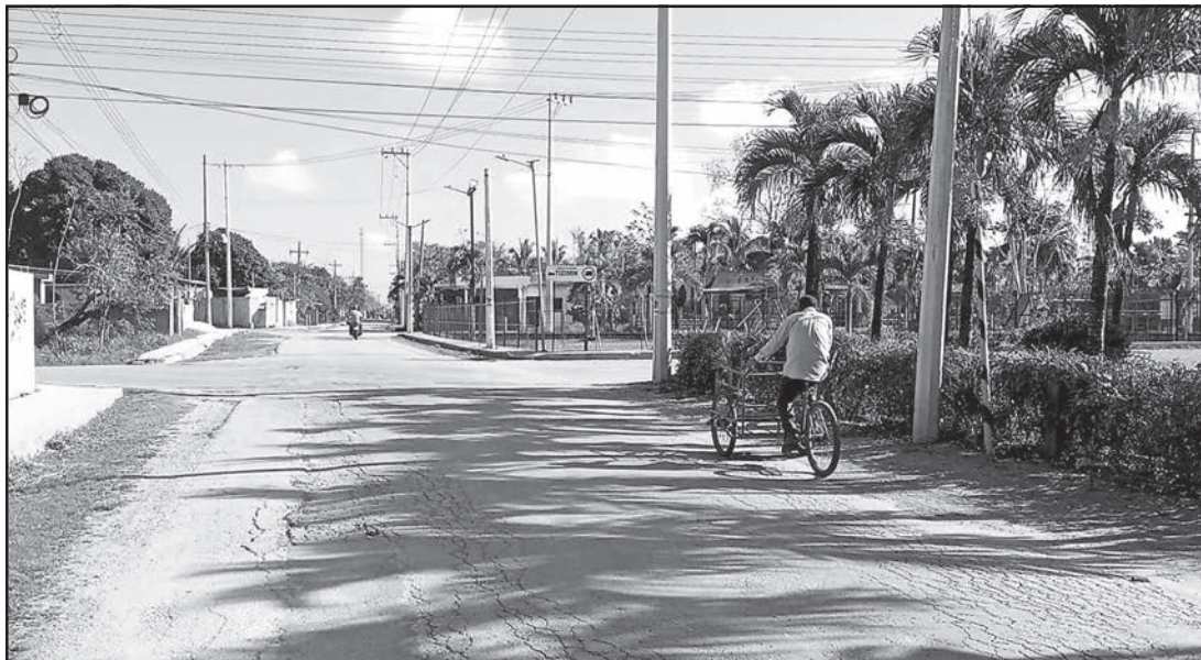
CFE informó que se reemplazaría el transformador, pero no había llegado el nuevo hasta la tarde de ayer. (E. Cauich)
