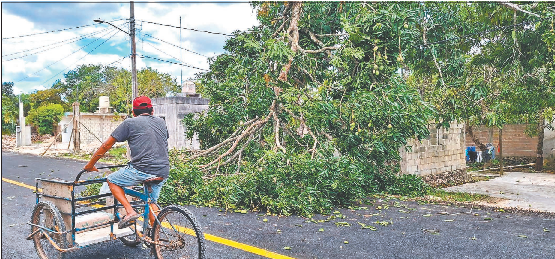
Vecinos de la zona dijeron que la tensión en las líneas de energía eléctrica podría ocasionar daños en los postes de concreto; pidieron apoyo a Protección Civil. (Justino Xiu)
