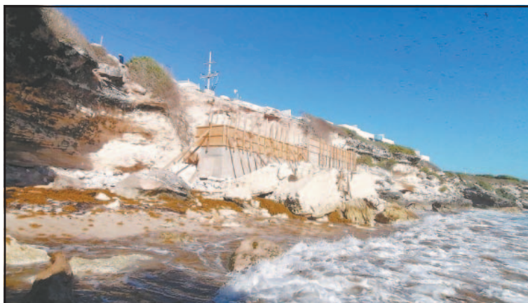
Ciudadanos detectan cavidades con riesgo de colapso. (O. López)
