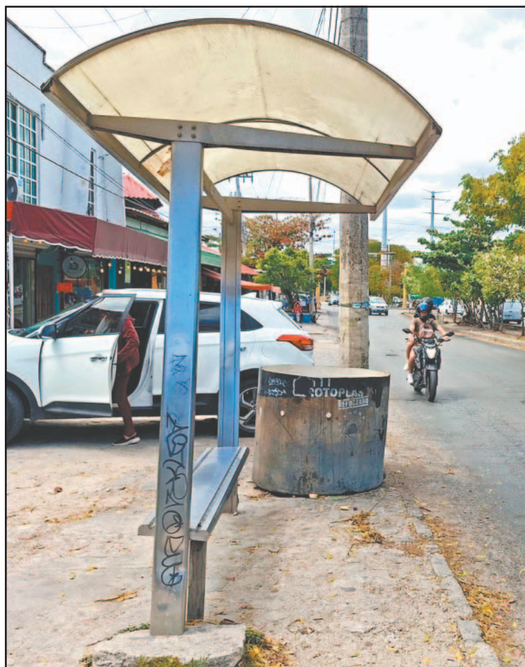
Muchas estructuras presentaron daños que afectan al usuario. (Liza Vera)
