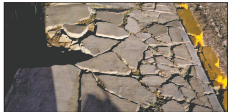
Vecinos exigieron rehabilitar tramo de 1.5 kilómetros. (O. López)
