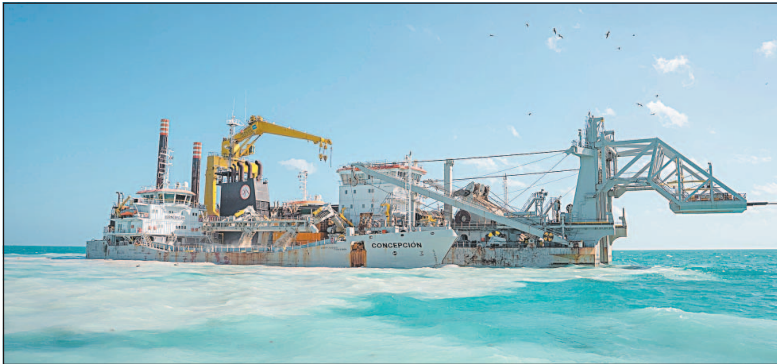
El material extraído del lecho marino —piedra caliza y sedimentos— se reutilizaría en la obra mediante relleno hidráulico. (POR ESTO!)
