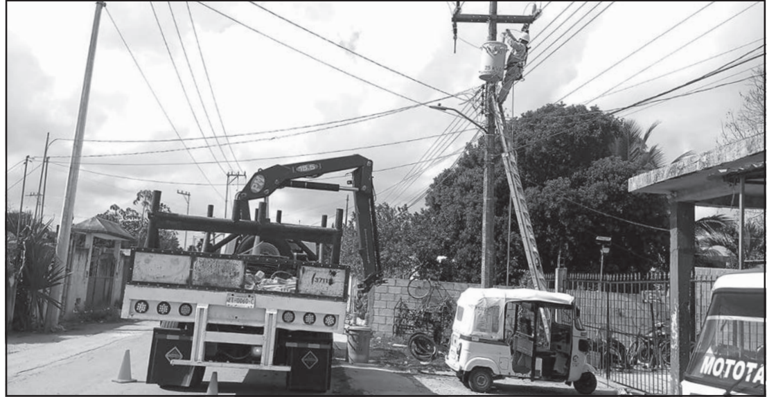
Según el supervisor de la compañía, en el municipio, realizaron mantenimiento a la red para optimizar el voltaje.
