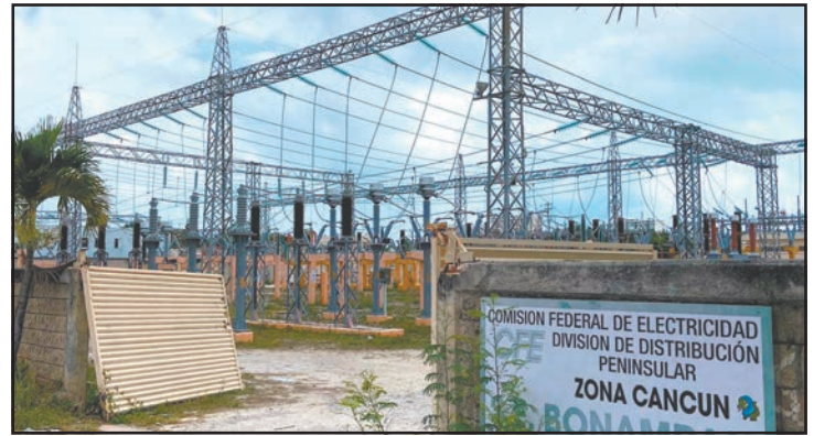
Dinamizaron un nuevo banco de capacitores en la Subestación Bonampak.
