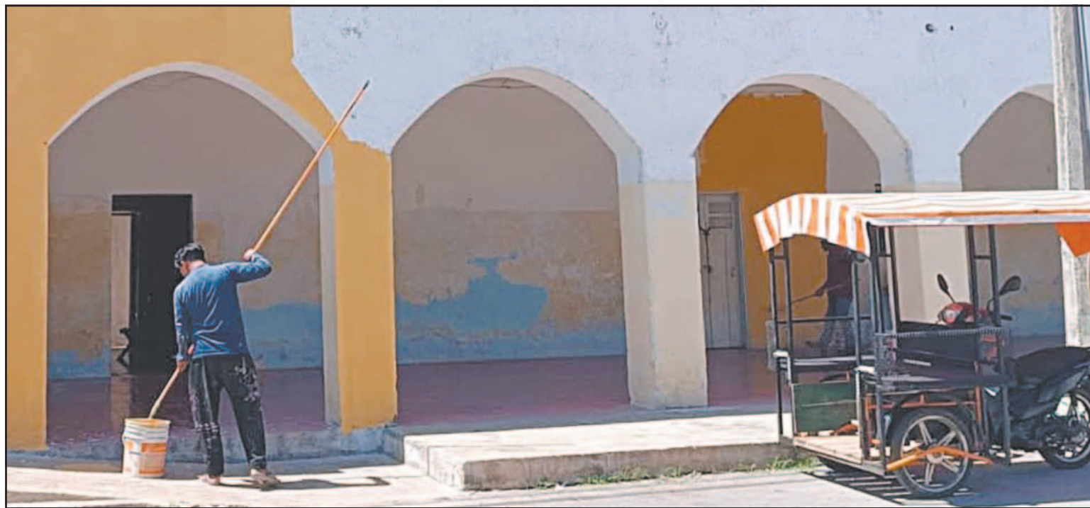
Previamente se realizaron trabajos de mejoramiento en las instalaciones, los cuales incluyeron pintura y mano de obra. (Alfredo Osorio)
