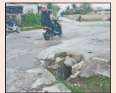
Advierten de posibles caídas.
