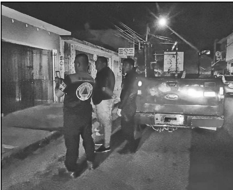
Un flamazo en el medidor eléctrico originó la presencia de humo.
