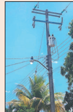
Vecinos de la vía 41 afirman que se desperdicia luz .
