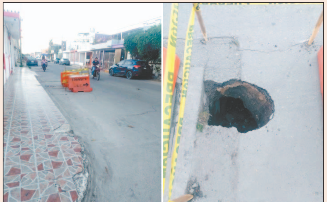
El hueco está ubicado en la calle Chablé, a unos pasos de la parroquia San José. (Fotos F. Olvera)
