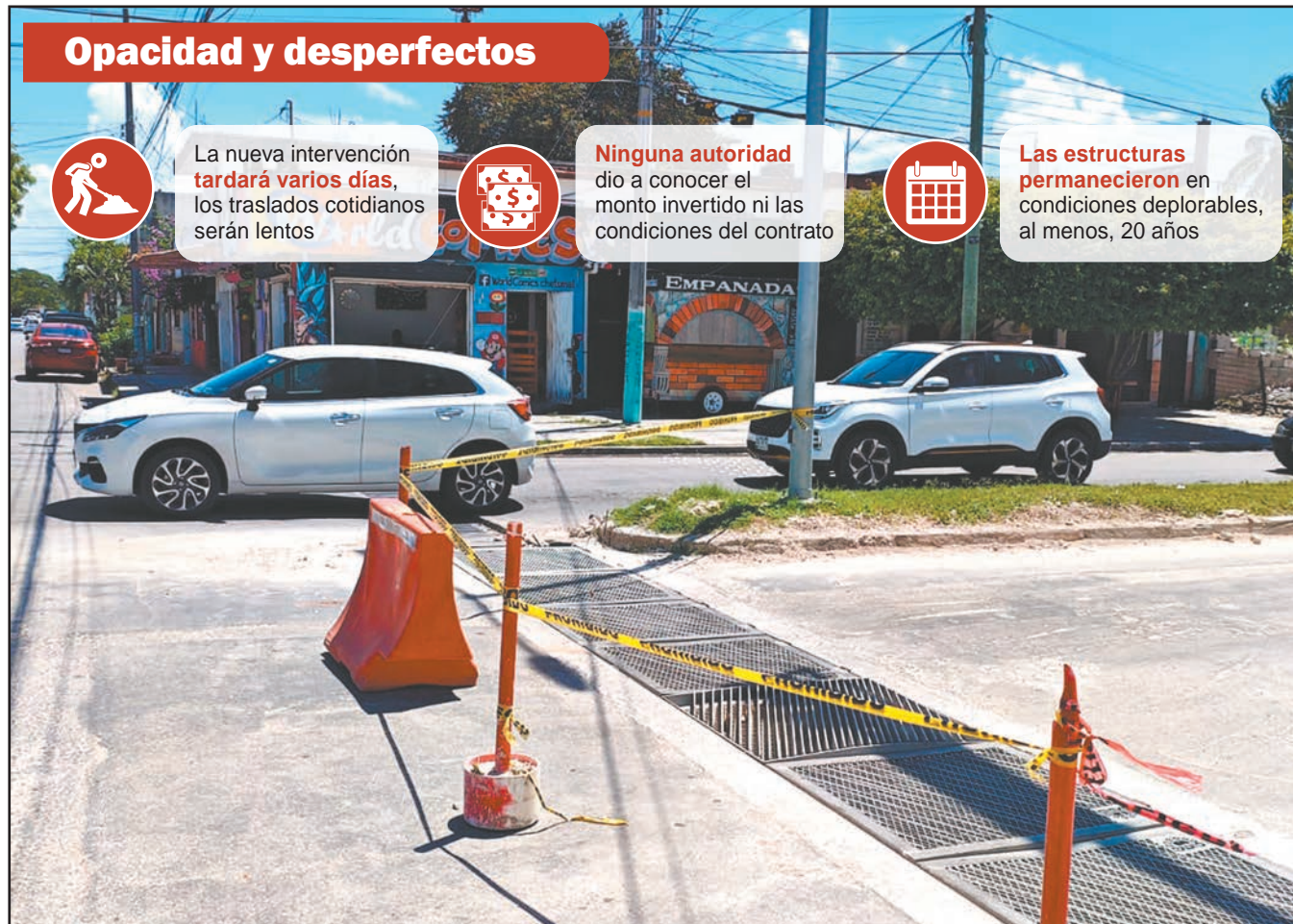
LAS rejillas de desagüe colocadas en el cruce de la avenida San Salvador y la calle Nápoles se dañaron en solo días; las expectativas generadas con el proyecto “se fueron por el caño” ante una evidente mala planeación y el uso de materiales “baratos”, afirman transeúntes.- (F. Olvera)
