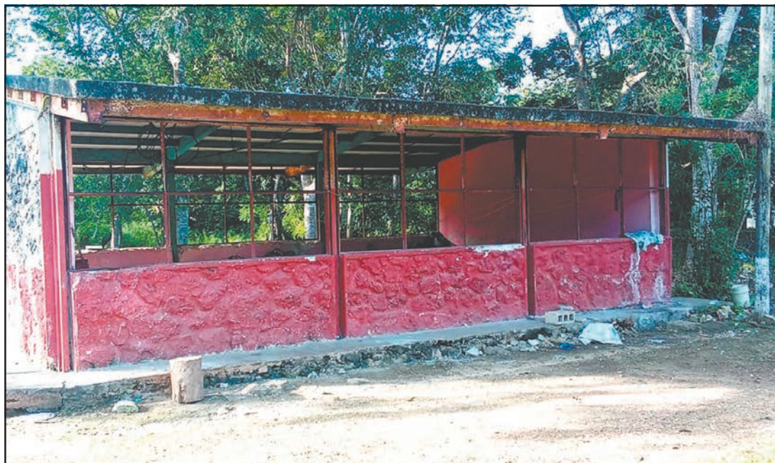
El inmueble usado como aula quedó abandonado y no se cuenta con servicios de Salud. (Enrique Cauch)
