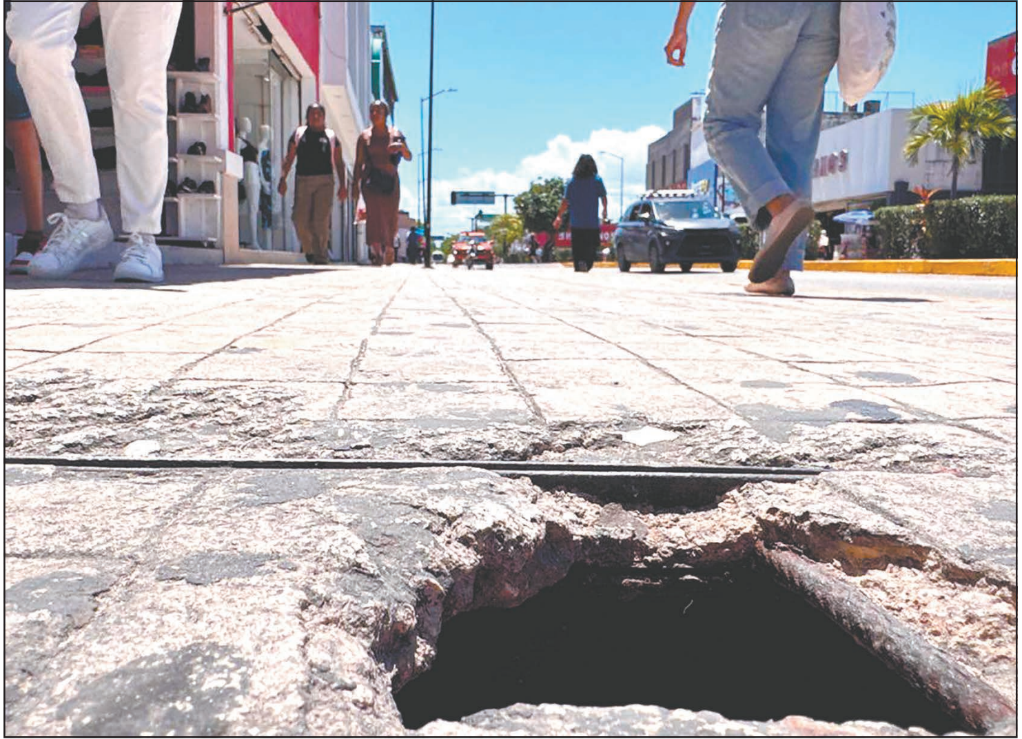
Ingenieros destacaron que la falta de mantenimiento en las vías provoca que el destino envejezca rápido y proyecte ambientes de inseguridad.
