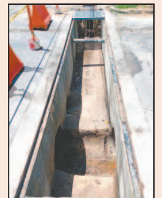
Un alcantarilla tuvo que ser retirada. (POR ESTO!)
