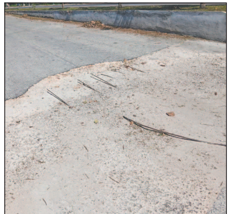
Hay varillas expuestas en plena avenida Solidaridad. (J. Guevara)
