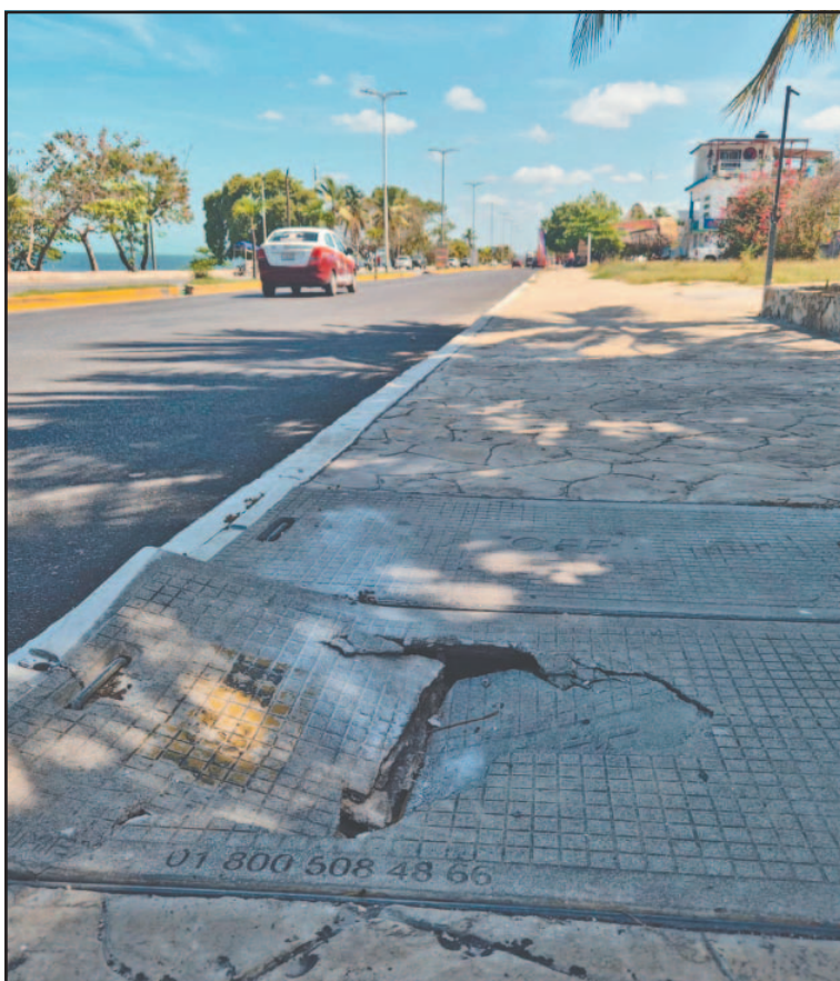
La empresa que rompió se fue y nadie hace por arreglar la situación.
