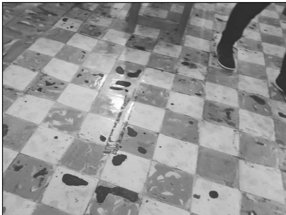
El suelo del histórico edificio poco a poco se levanta más y está desnivelado. (E. Caamal)
