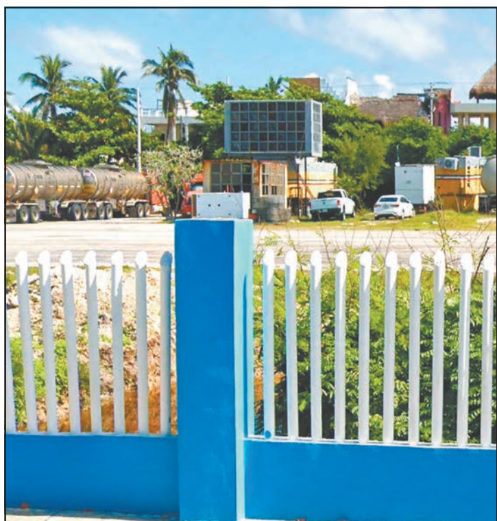
Persisten quejas por generador cerca de viviendas. (Ovidio López)
