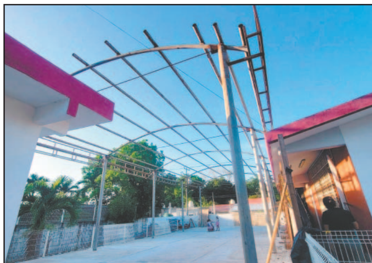
El techo del domo de la "Doroteo Arango" no fue colocado. (E. Silva)
