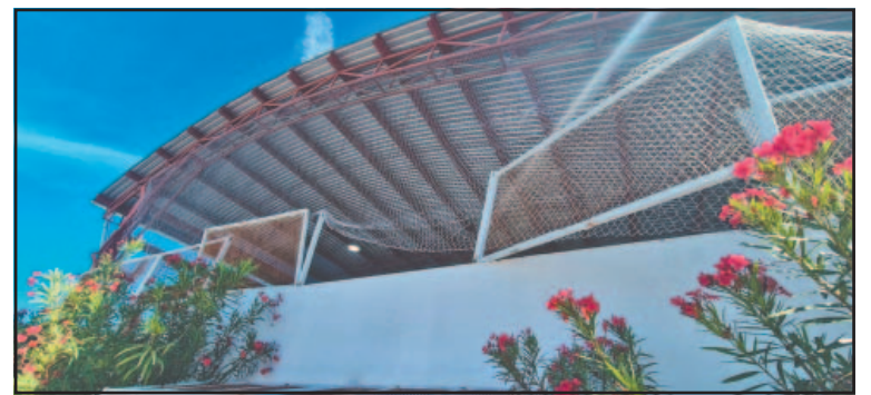
La infraestructura necesita que se refuerce su soldadura. (Jorge May)
