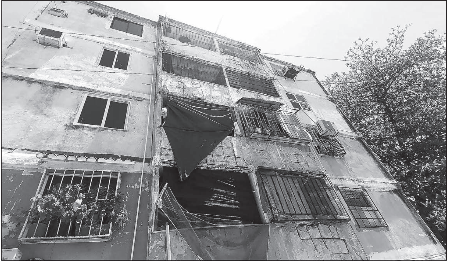
Muchos inmuebles presentan desprendimiento de fachadas, caída de voladizos y paredes con graves afectaciones. (Fotos Erick Romero)
