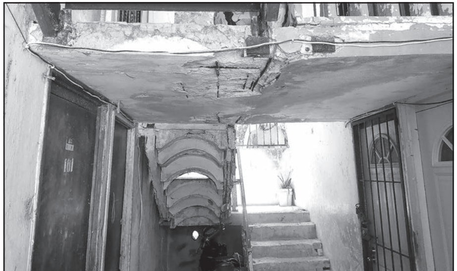
La problemática no es reciente, pues hace años una parte colapsó debido al mal estado.
