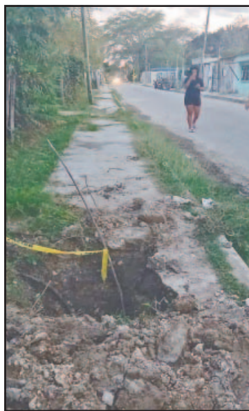
Hace una semana repararon la fuga, pero no taparon el hueco.
