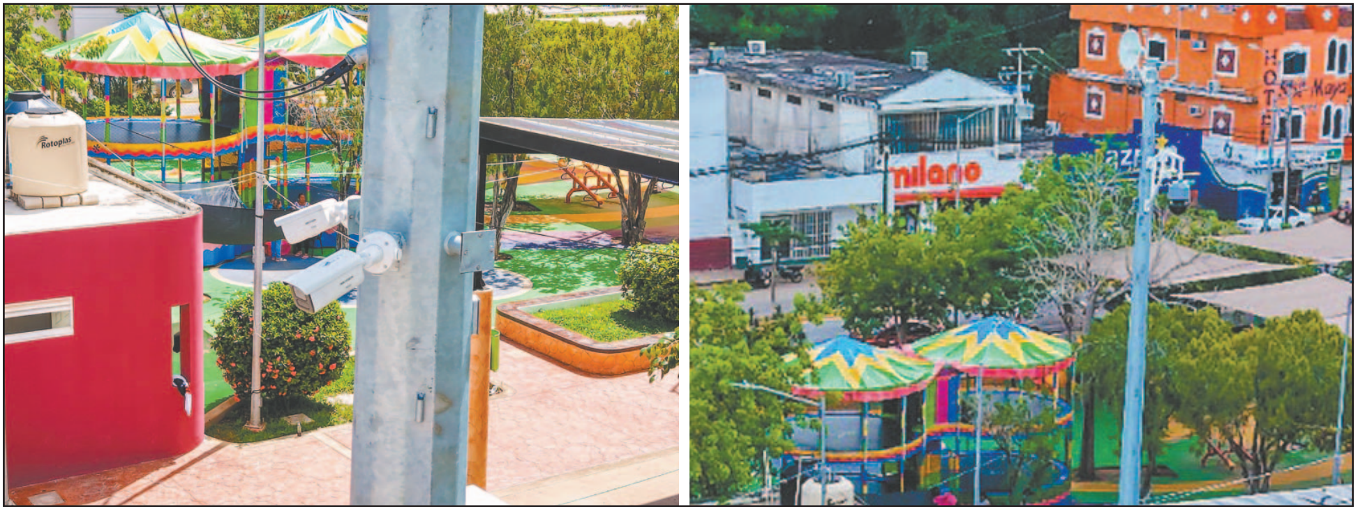
Estos dispositivos con tecnología avanzada permitirán una supervisión permanente, incluyen visión infrarroja, múltiples ángulos y monitoreo a larga distancia. (Fotos R. Chan)
