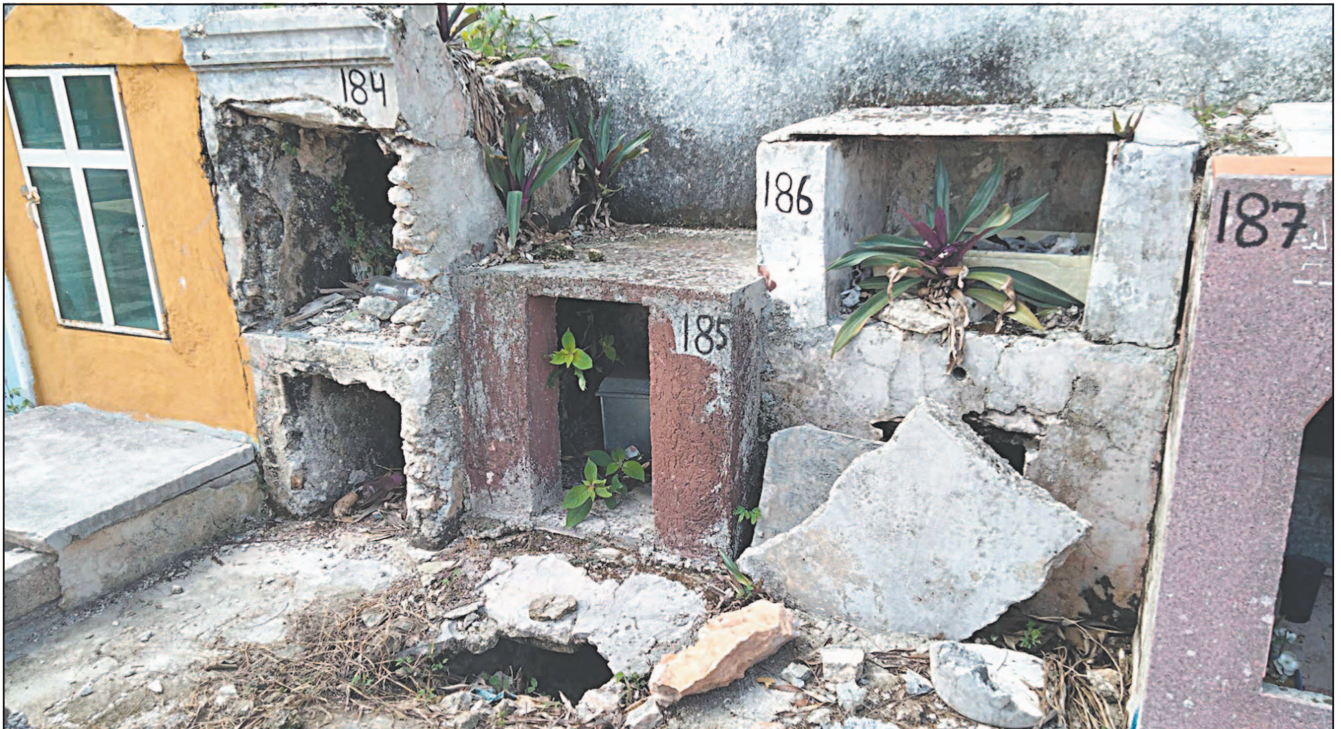
Los encargados del camposanto señalaron que aunque la mayoría de las familias ha puesto en regla sus espacios, todavía hay criptas en mal estado. (POR ESTO!)
