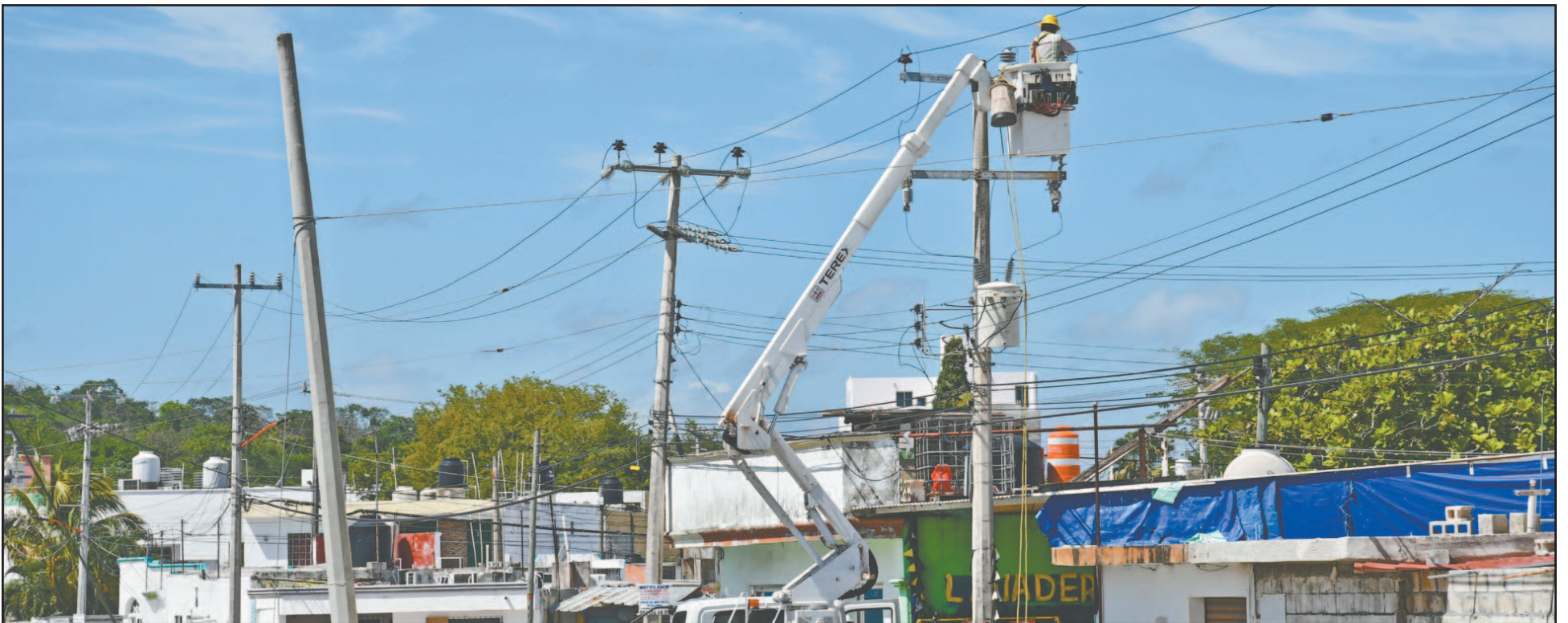
Las labores de revisión del cableado, postes y transformadores requiere de bastante tiempo para poder garantizar un servicio de calidad a toda la ciudadanía. (POR ESTO!)
