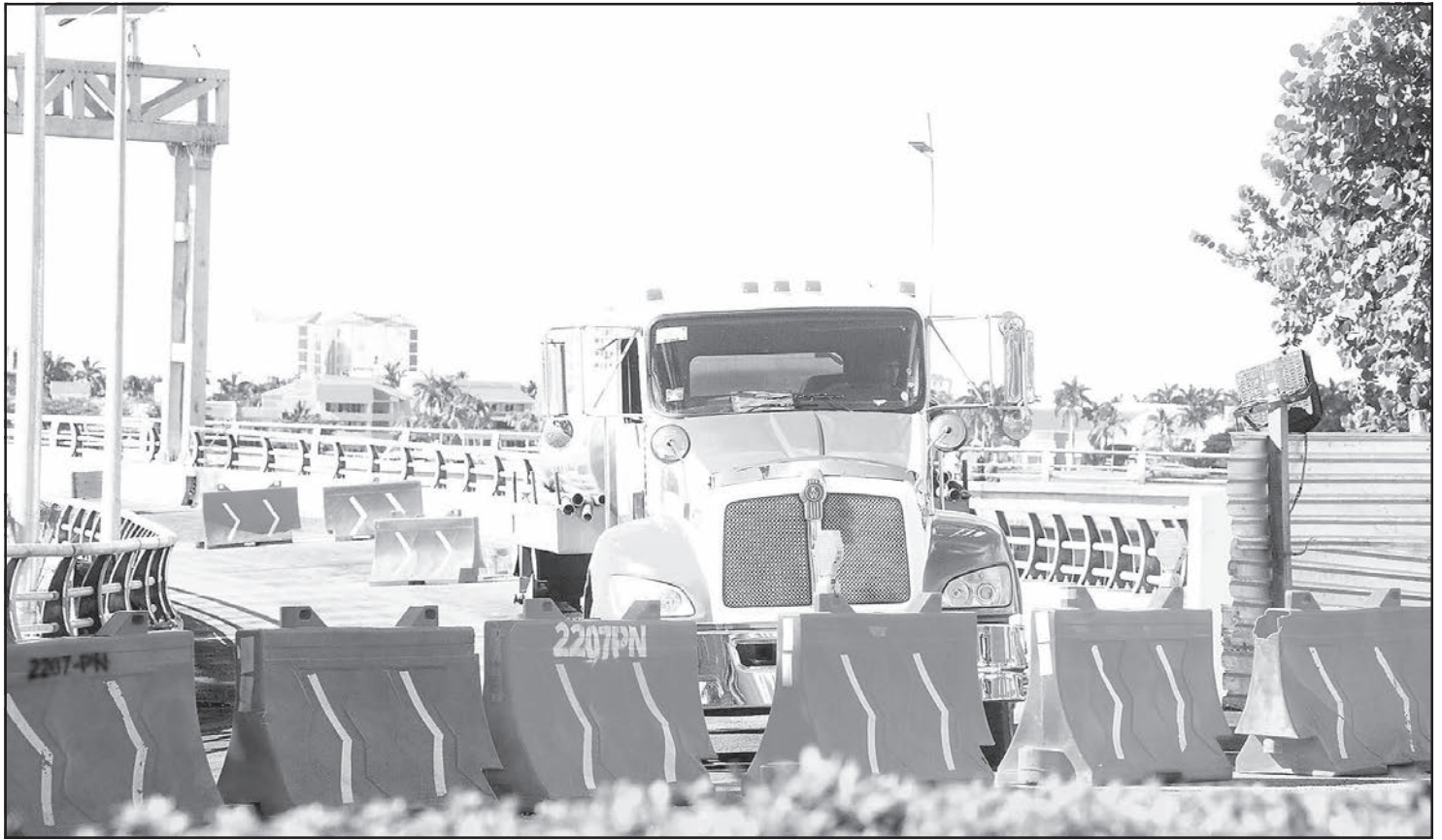
Los trabajadores montaron mil 658 trabes y llevan a cabo pruebas de carga con vehículos de hasta 148 toneladas. (Fotos Liza Vera)
