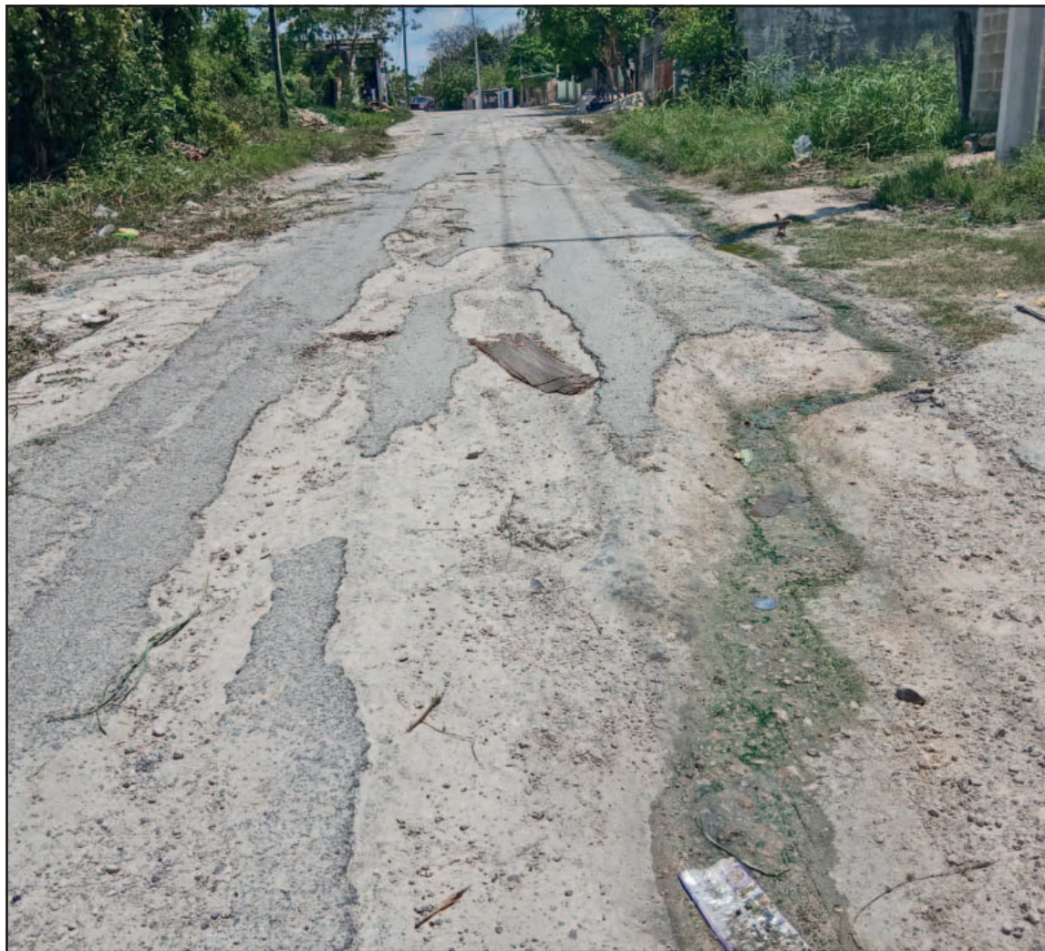
Transitar esta arteria es un peligro para los habitantes, principalmente cuando llueve y se encharca.
