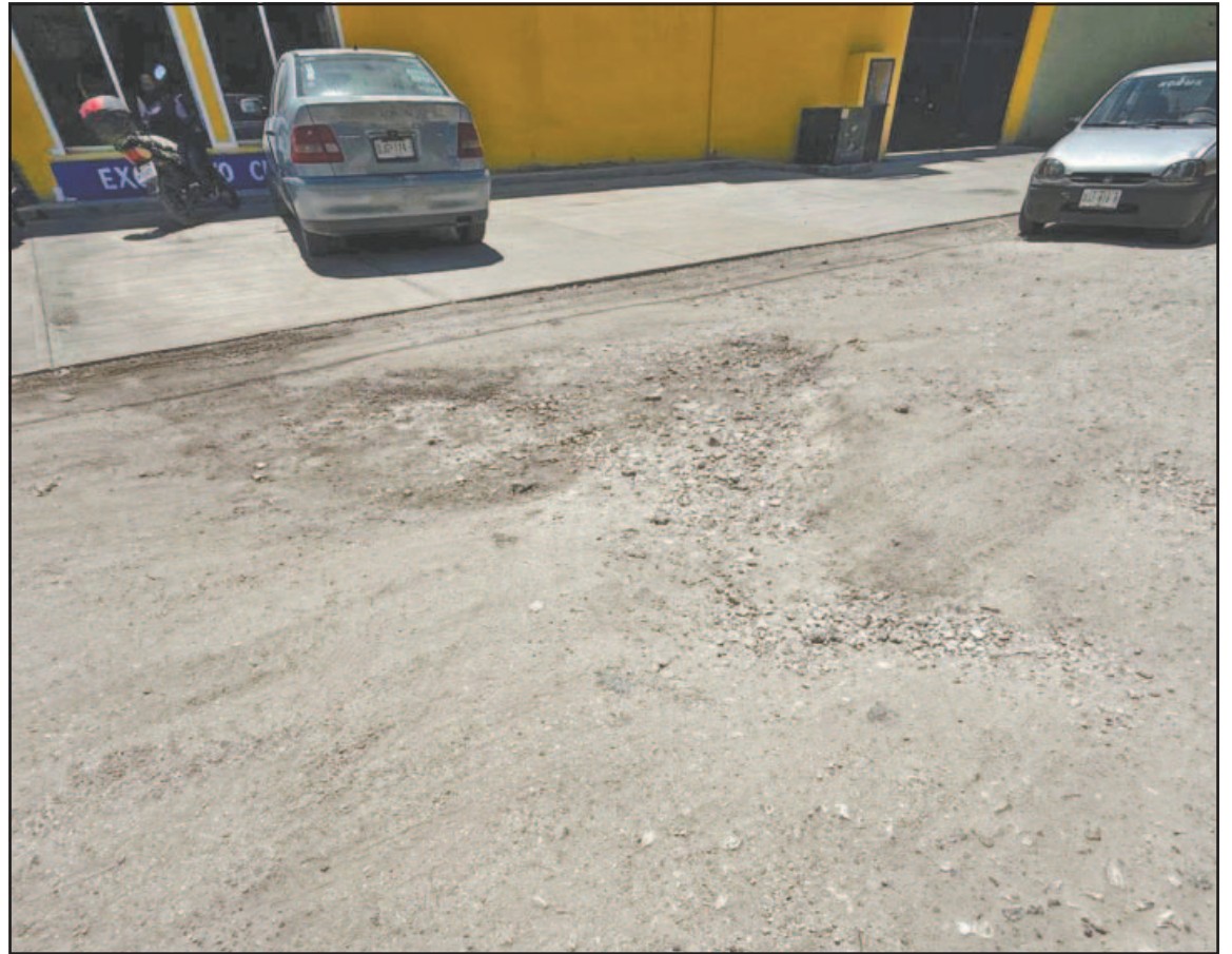
La gravilla suelta y el desnivel del suelo que no se percibe, son la causa de múltiples accidentes viales.
