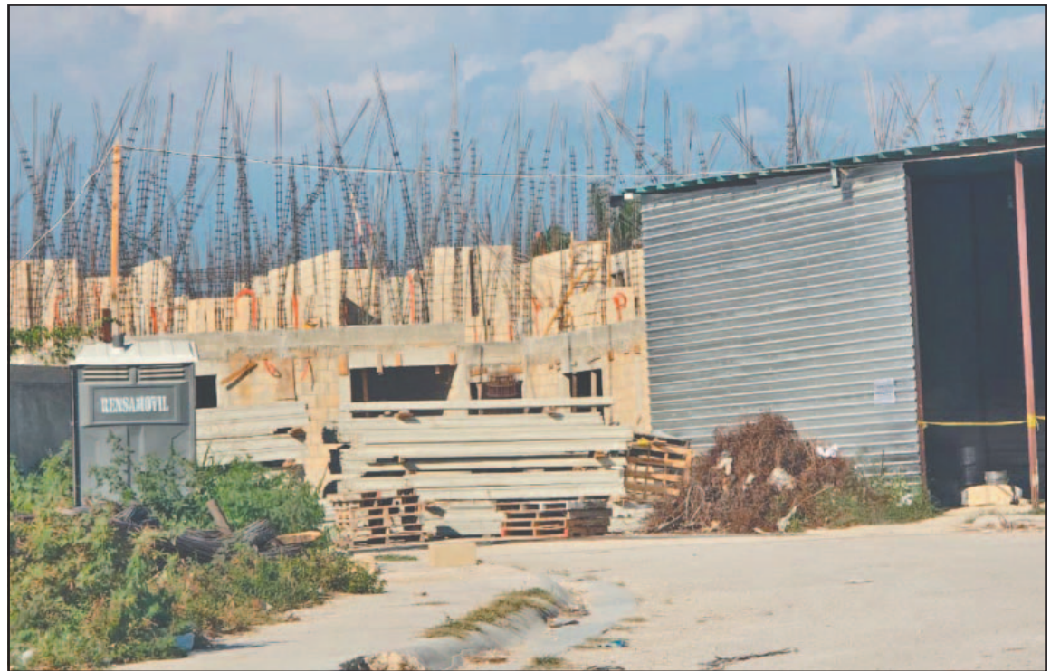
Personal del Ayuntamiento y Protección Civil acudieron a colocar los precintos de clausura. (A. Pech)
