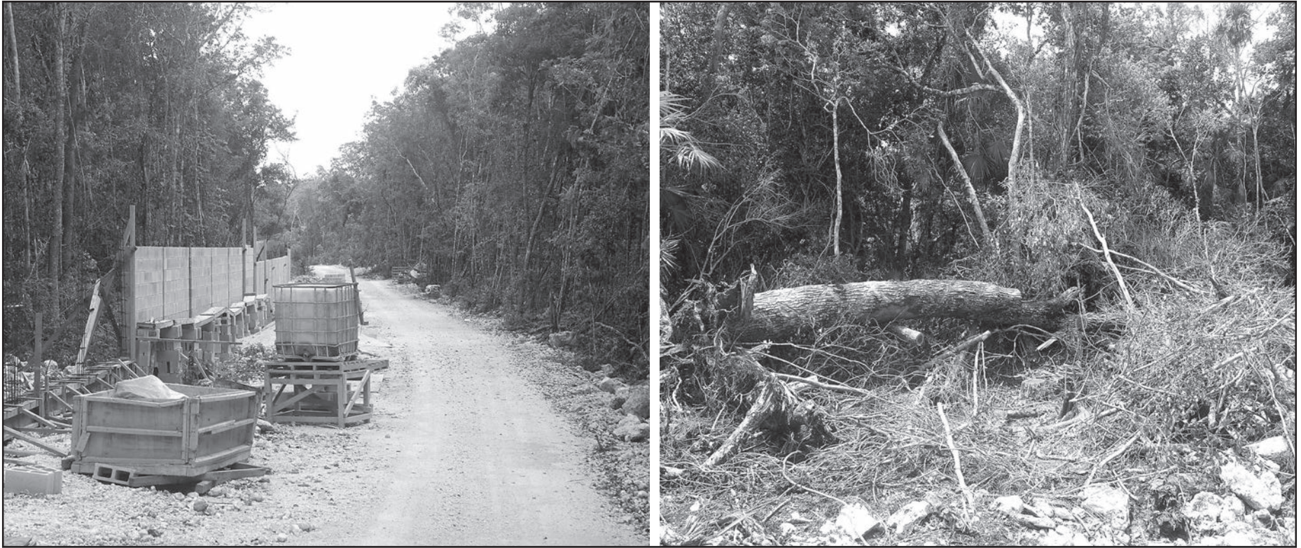
Los propios albañiles admitieron que el deterioro de vegetación es evidente, lo cual también les inquieta; sin embargo, dijeron que son órdenes de sus superiores. (Fotos Erick Romero)
