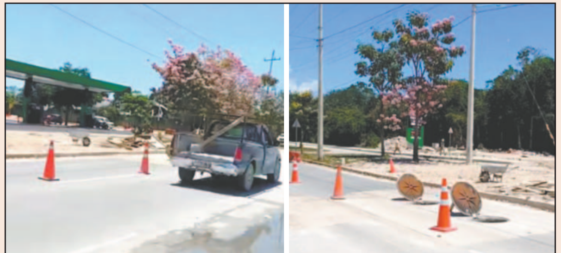
Ciudadanos comentaron que la circulación se complica a la altura del Súper Aki. (Fotos POR ESTO!)
